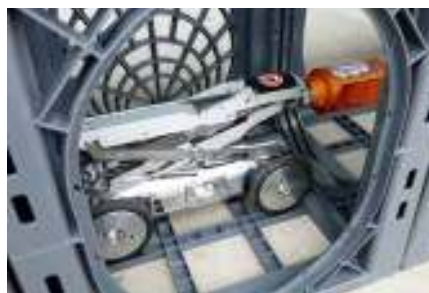
> Kamerabefahrung ohne Inspektionsschiene
